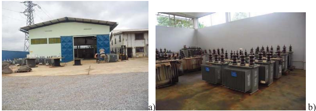
Photo n°15 : Magasin de stockage des à PCB de Ngousso à Yaoundé : (a) vue extérieure (source (année)) et (b) vue intérieure (source (année)).
