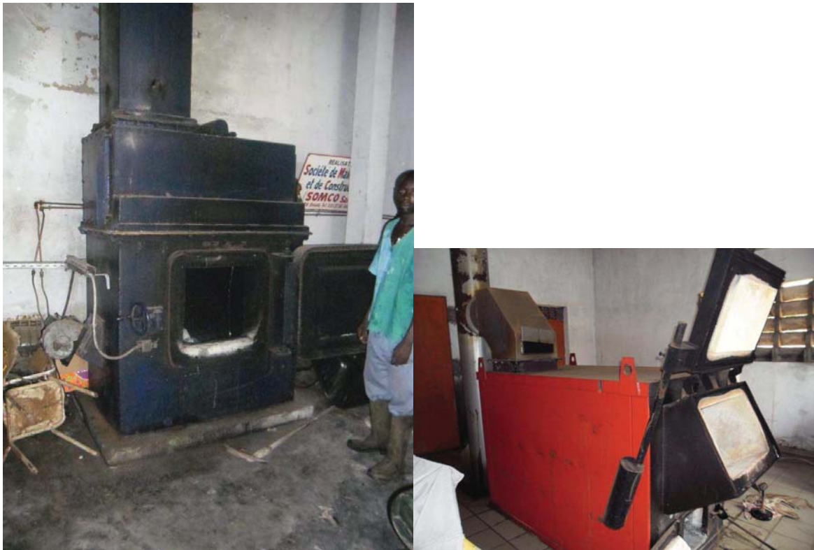
Photo 19: Incinérateur des déchets hospitaliers à l'hôpital Laquintine à Douala.
